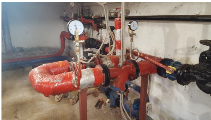
Рис. 1. Существующий тепловой пункт
