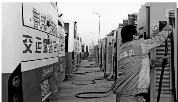
Рис. 5. Подключение к ЭЭС посредством кабельной сборки от стандартизированного разъема (концепция длительной зарядки), при этом ЭЭС располагается на земле
