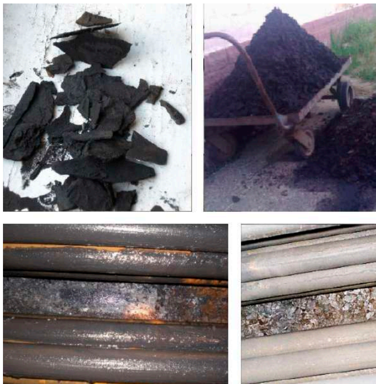
Рис. 6. Пример очистки наружной поверхности жаровых труб водогрейного котла от накипно-коррозионных отложений
