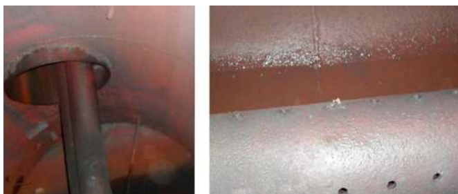
Рис. 3. Вид на паровое пространство бака питательной воды. Вид нижней части бака (справа) через 11 месяцев после обработки (2014 г.). Отчетливо видна защитная пленка
