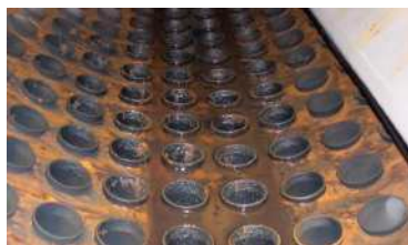
Рис. 4. Состояние труб конвективных пучков через 11 месяцев после обработки (2014 г.)
