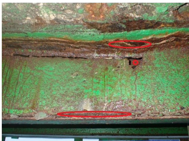
Рис. 2. Элемент с коррозионными повреждениями (красным выделены поврежденные зоны, зафиксированные в ходе предыдущего обследования)
