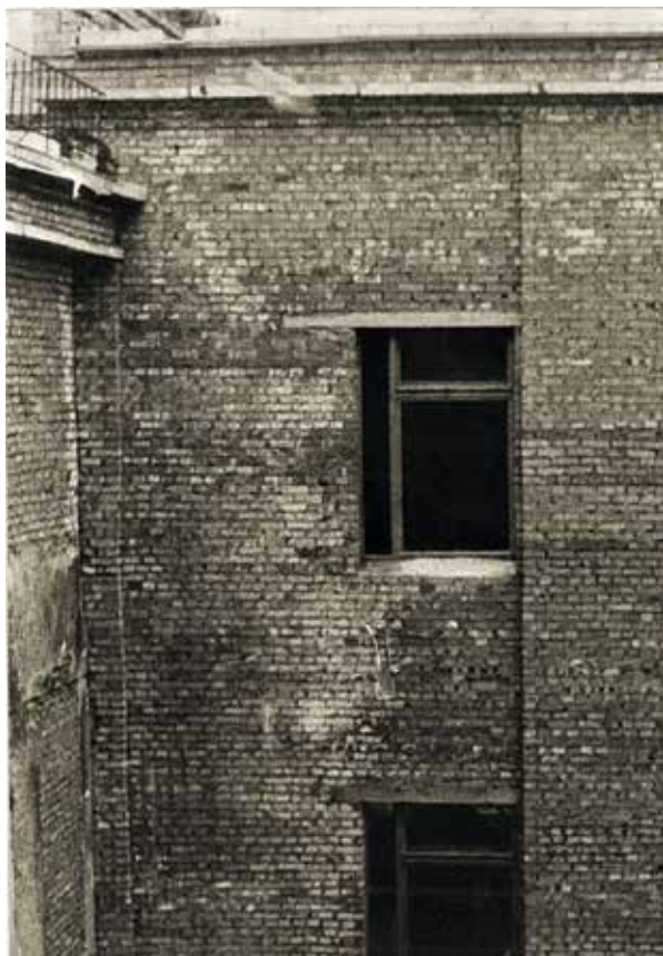
Высолы на кирпичной стене строящегося здания
