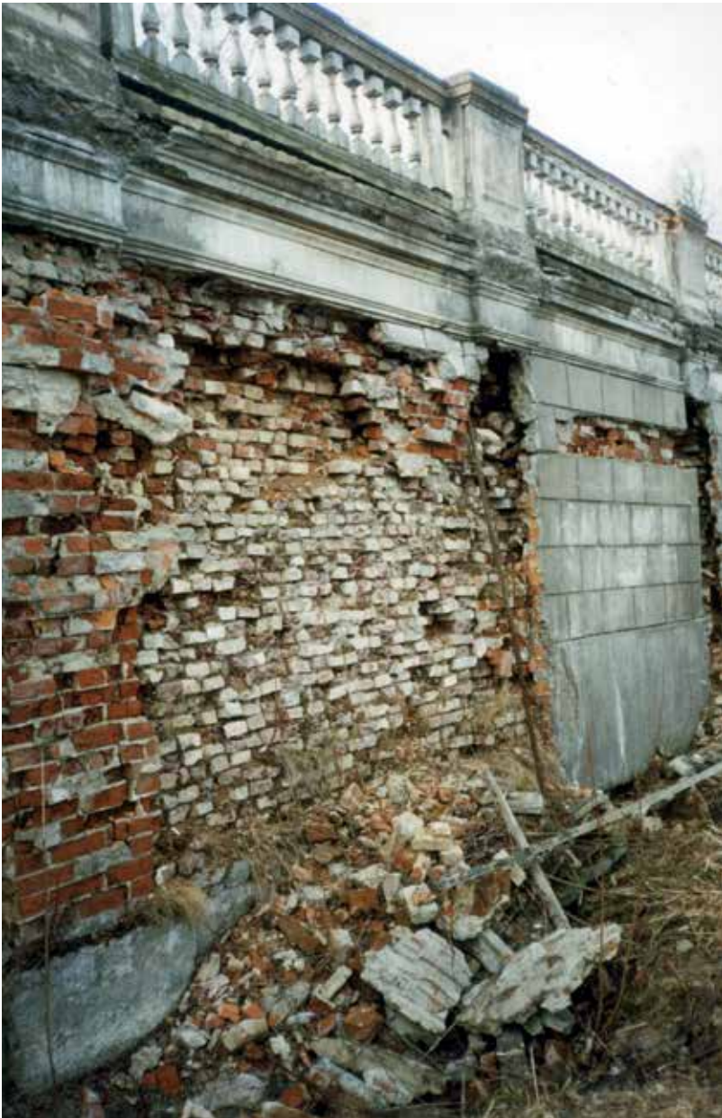
Разрушение кирпичной кладки в результате солевой коррозии и биодеградации
