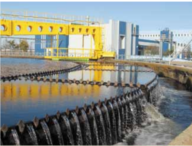
Первичный отстойник на Северной станции аэрации
