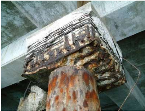
Рис. 5. Коррозия стальной арматуры
