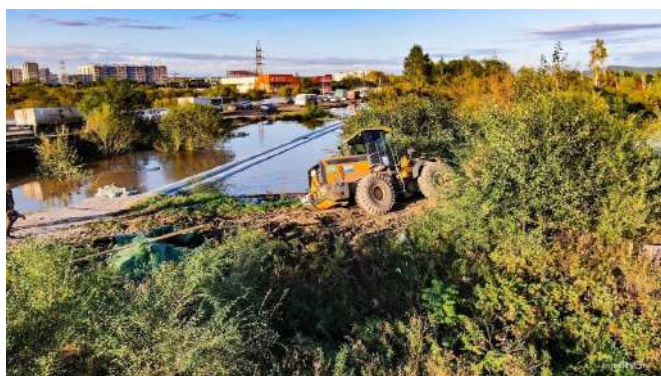
Рис. 5. Опрокидывание на рыхлом грунте
