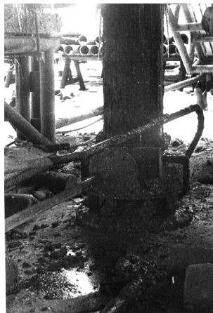
Рис. 4.7. Приустьевая зона скважин: а – при традиционном бурении; б – с применением рефрижераторного шахтового направления
