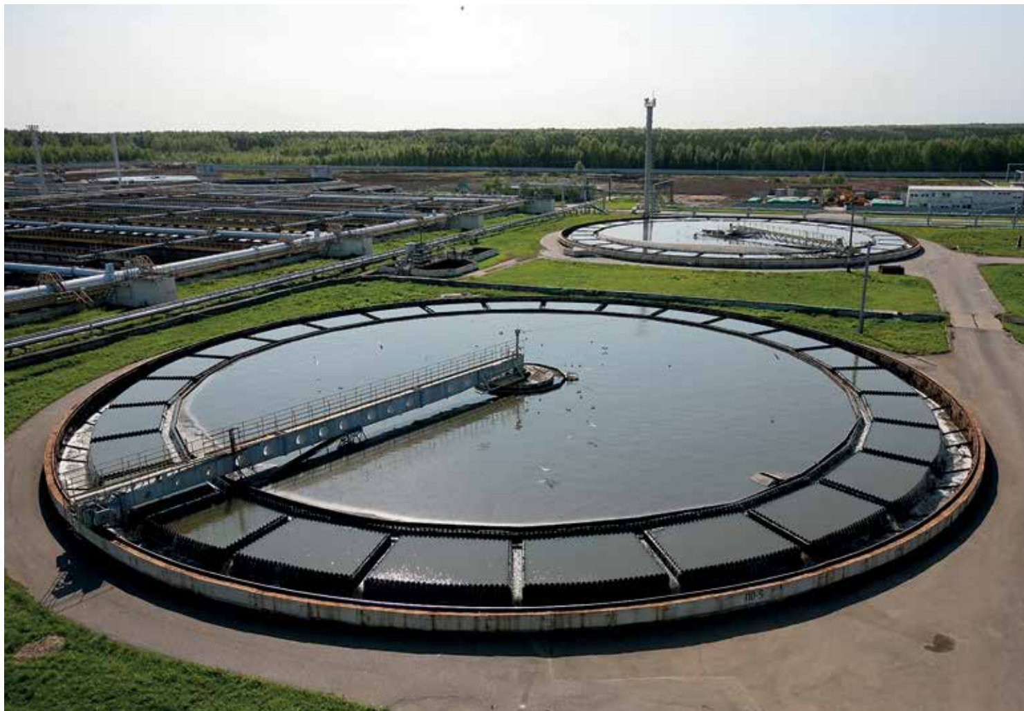
Северная станция азарити. Качество очистки сточных вод в Санкт-Петербурге полностью соответствует рекомендациям ХЕЛКОМ
