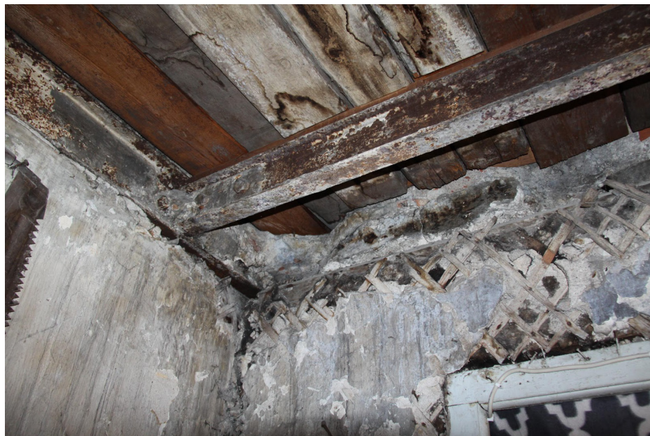
Рис. 6. Коррозия металлической балки чердачного перекрытия вследствие отсутствия гидроизоляции кровельного покрытия
