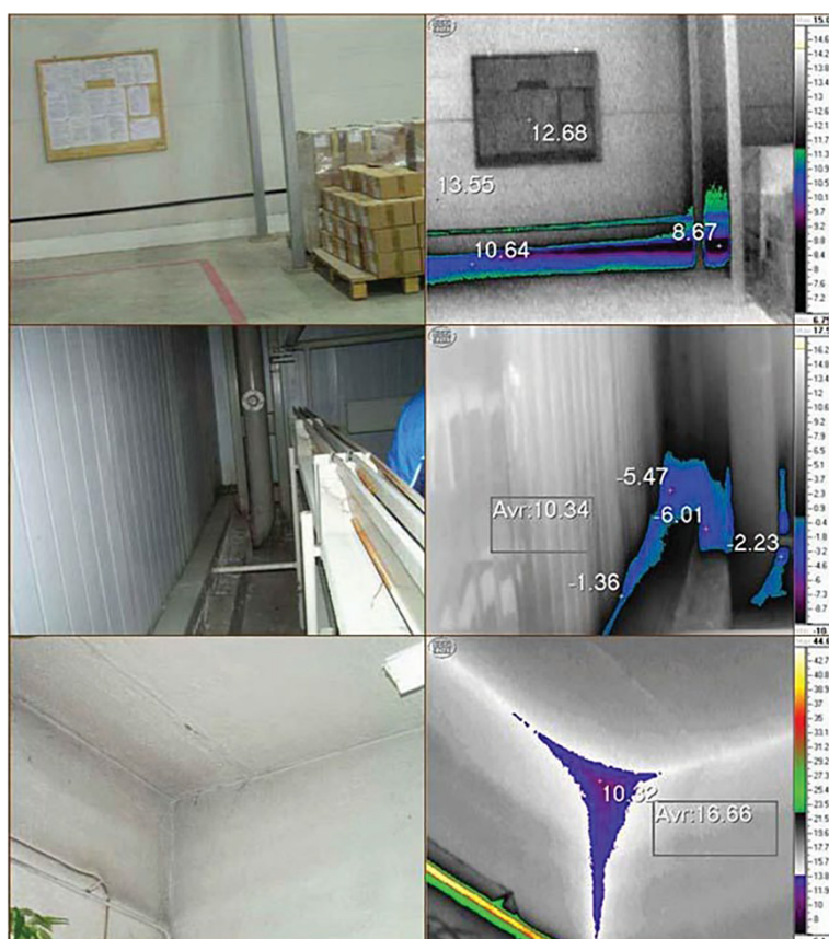
Рис. 6. Дефекты стыковых соединений, возникшие при монтаже: а – цифровой снимок; б – инфракрасный снимок
