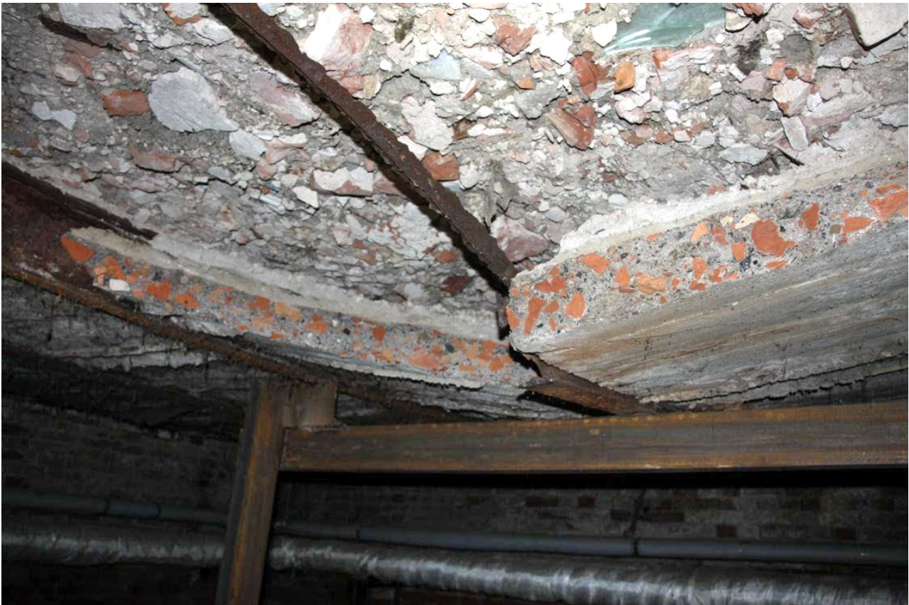
Рис. 2. Визуальный прогиб балки. Обрушение надподвального перекрытия вследствие неудовлетворительной эксплуатации конструкции перекрытия в течение длительного времени
