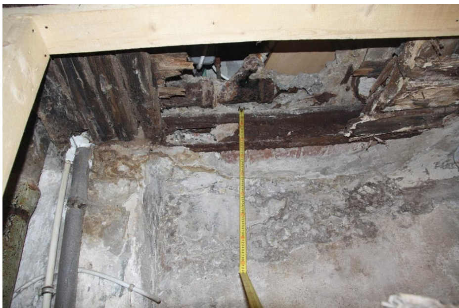
Рис. 5. Сквозная коррозия металлической балки межэтажного перекрытия в «мокрой» зоне, вследствие протечек инженерных сетей канализационной трубы в перекрытии
