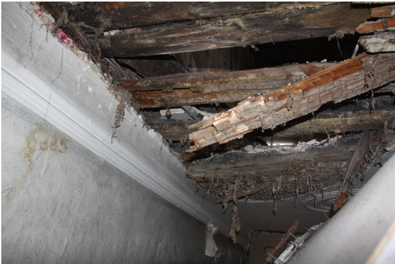
Рис. 1. Обрушение деревянной балки перекрытия вследствие гниения до 100% по сечению
