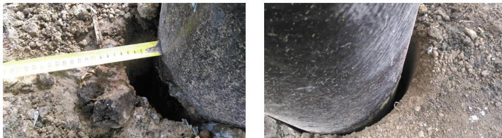
Рис. 6. Смонтированная свая с нарушением технологии по лидерному бурению
