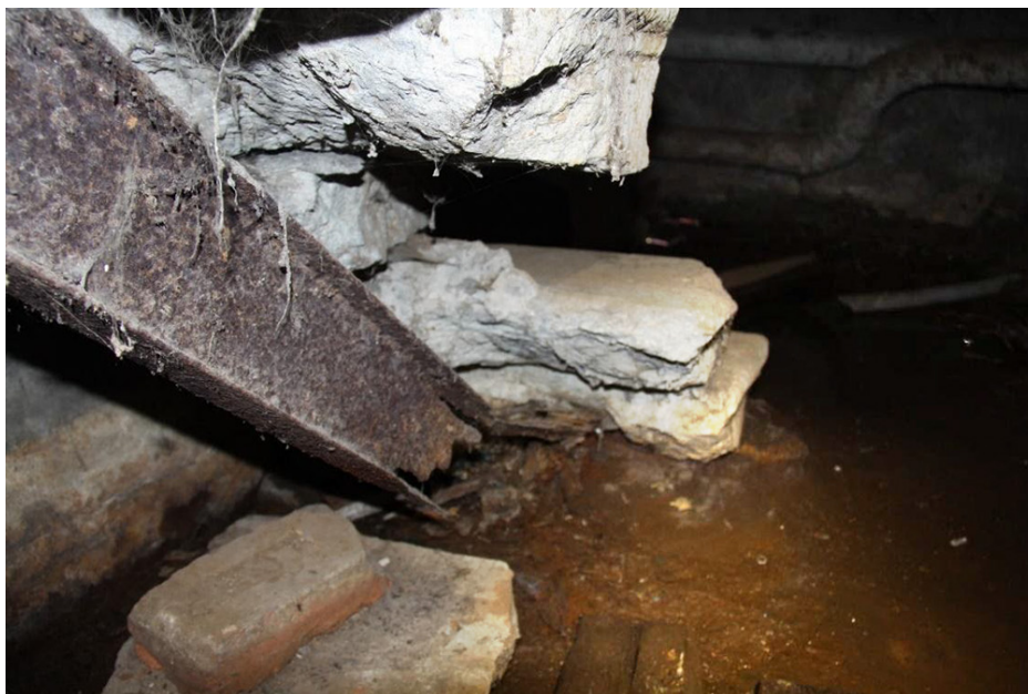
Рис. 4. Сквозная коррозия металлического косоура, вследствие нахождения в зоне постоянной влажности (в период увеличения уровня грунтовых вод – в воде)
