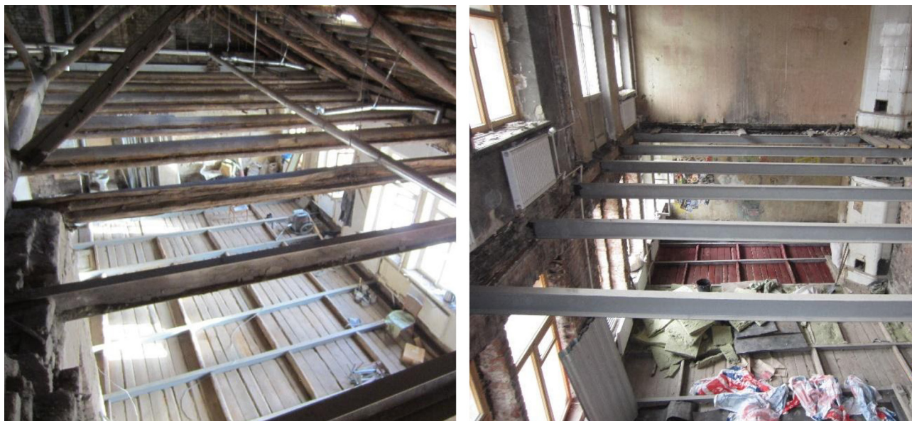
Рис. 3. На левом фото балки без противокоррозионной защиты. На правом фото балки покрыты противокоррозионной защитой
