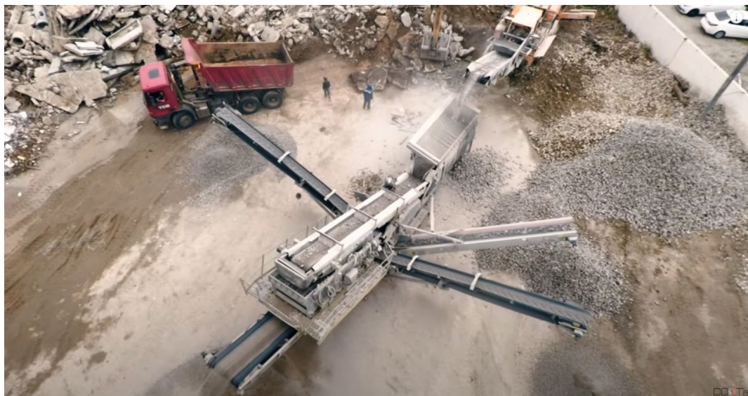
Рис. 4. Переработка бетона на полигоне. Производство состоит из 5 машин, производительность 800 м 3 продукции в смену
