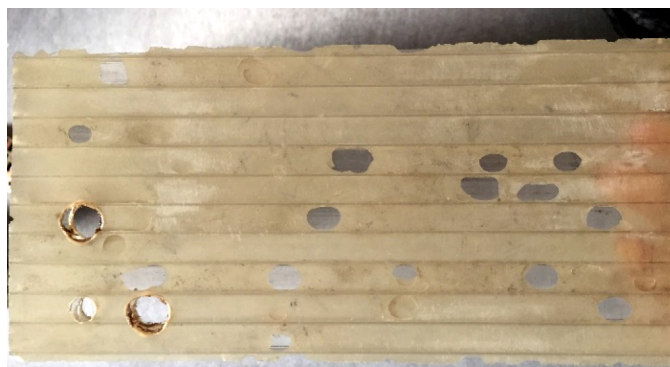
Рис.2. Пример разрушения поликарбоната после 3-х лет эксплуатации на животноводческом объекте
