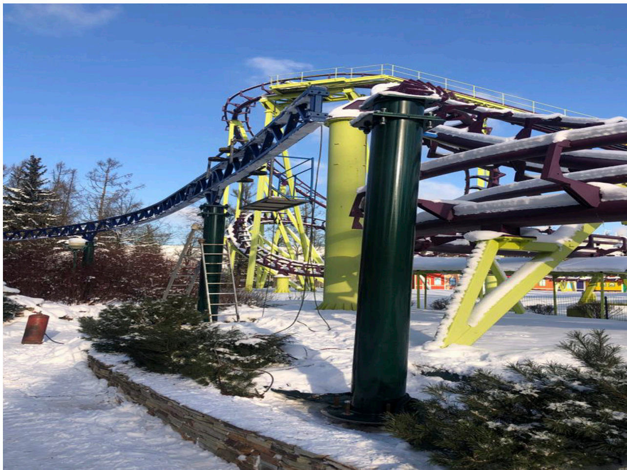
Рис. 1. Монтаж колонн и ферм трека аттракциона «Воздушная железная дорога» (г. Санкт-Петербург. Приморский парк. Февраль 2021г.)
