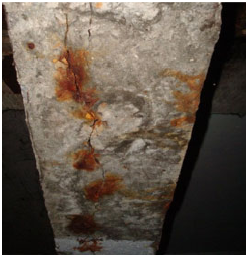
Рис. 1. Ржавчина на поверхности бетона в результате действия коррозии
