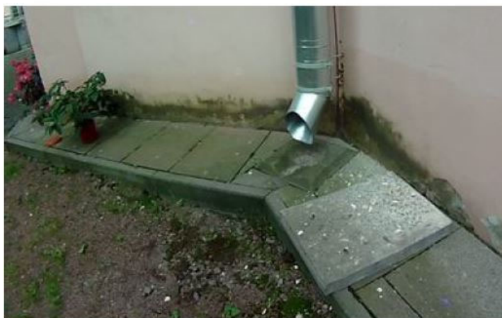
Рис. 1. Визуальный осмотр внешних повреждений
