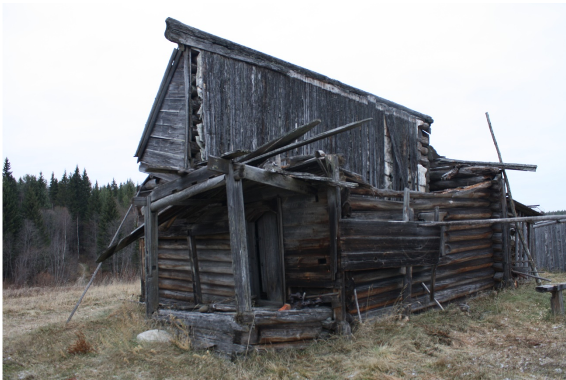
Рис. 1. Часовня в аварийном состоянии
